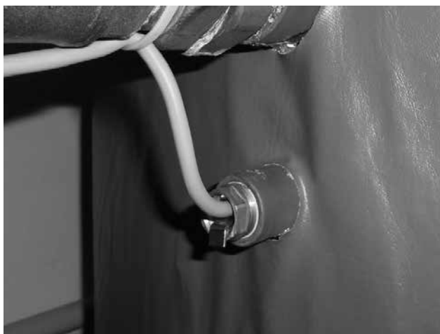
Rys. 14 - widok czujnika temperatury wody podłączonego do zbiornika akumulacyjnego (TV i TS)
